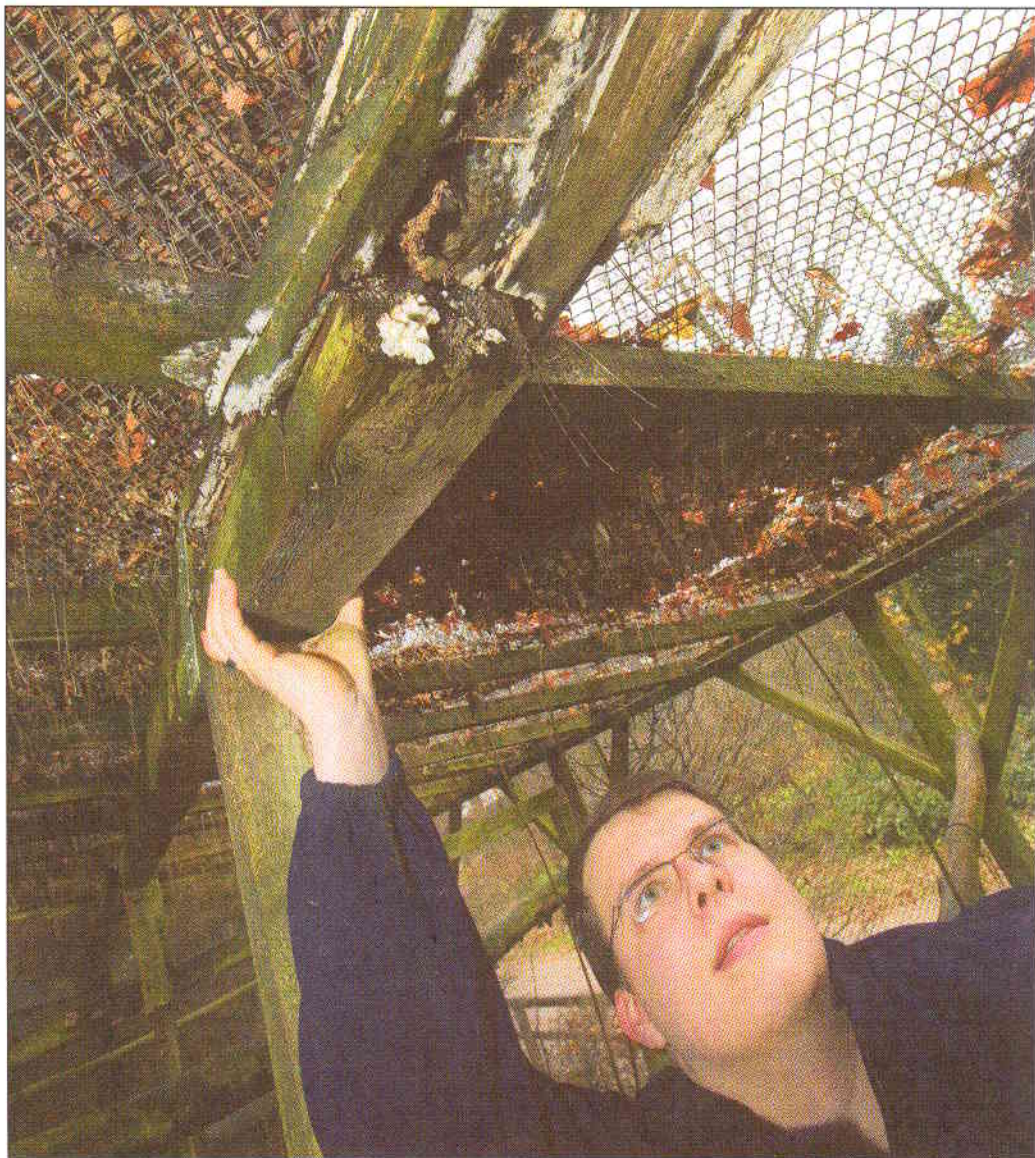
Wie baufällig das alte Gehege für Füchse, Frettchen und Wildkatzen ist, zeigt Fasanerie-Azubi Hendrik Brehm. Foto: RMB / Windolf
